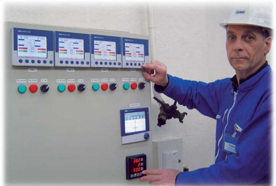
Schaltpult oder Schaltkonsole für Regelung, Archivierung und Alarmübertragung
